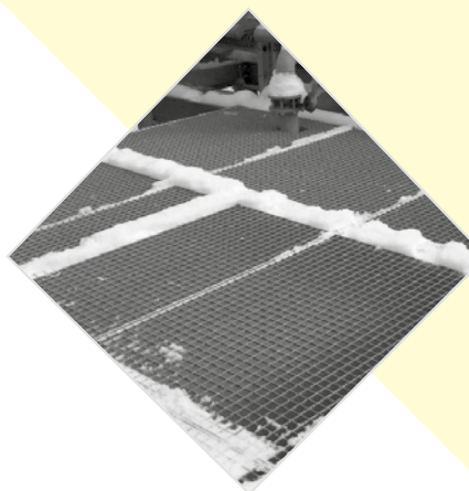
Рис. 2. Состояние ходового мостика из решетчатых настилов.
